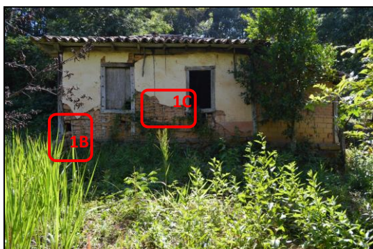
Figura 1A: Edificação residencial abandonada, Mariana, Distrito de Cachoeira do Brumado, 2014. Fotografia do autor.
