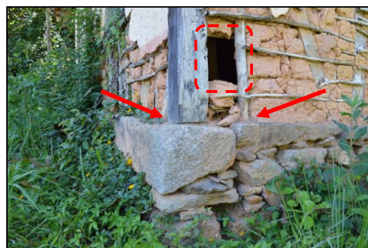
Figura 1B: Esteio e pau da trama apoiando-se diretamente no fundamento de pedra (setas); perda do preenchimento de barro (área tracejada), 2014. Fotografia do autor.
