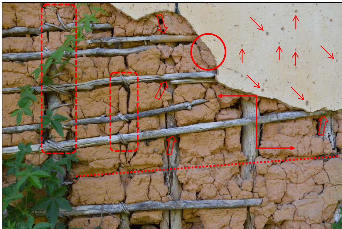
Figura 1C: Padrão de amarração das varas aos paus da trama (áreas tracejadas); perda dos vínculos de amarração (setas largas); perda de vara da trama (área pontilhada); desprendimento de emboço e reboco (área circulada); fissuras no enchimento de barro (seta dupla); erosão provocada por agentes atmosféricos (setas finas); presença de vegetação na trama, 2014. Fotografia do autor.
